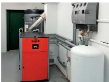
Vzorová kotelna s kotlem ROJEK PK BIO 40
