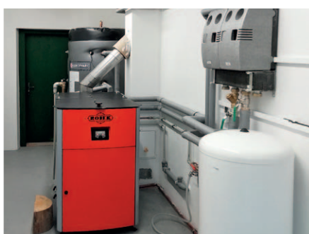
Vzorová kotolňa s kotlom ROJEK PK BIO
